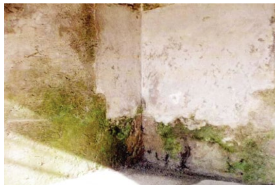
Obr.2 Typické poškození solným výkvětem
